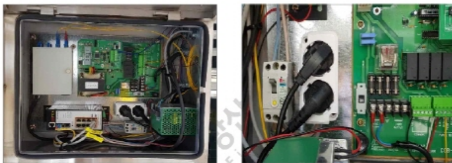
【전동기 제어반 내부 점검 예시】
