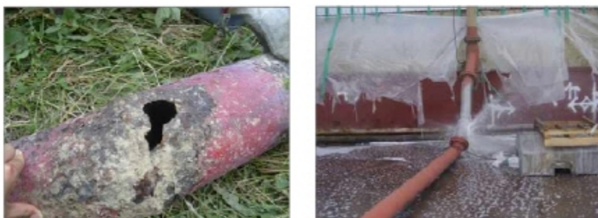
[배관 파손 사례]
