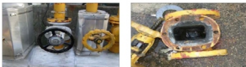
[밸브 파손 사례]
