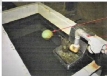
【흡수장치의 자동급수장치 점검】
