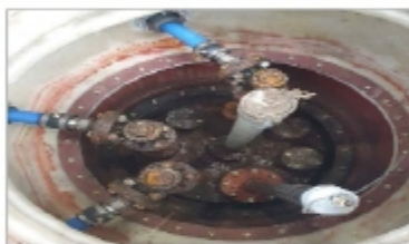
[맨홀 상부 배관]
