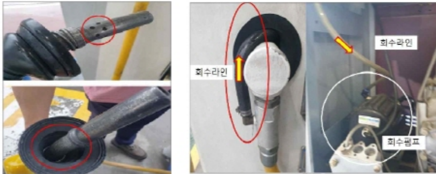
[Stage II] 유증기 회수 노즐 및 라인·펌프
