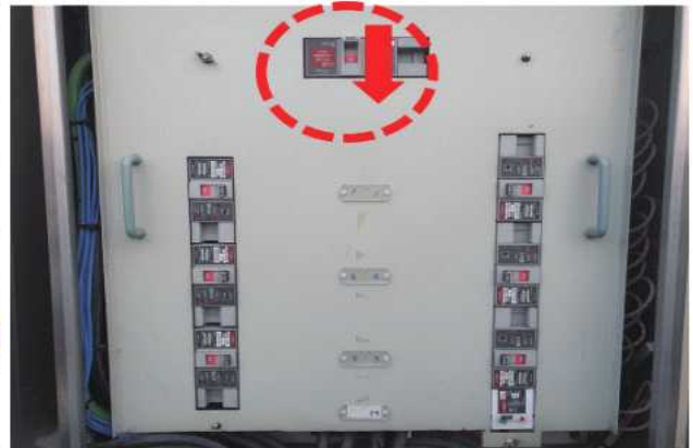
[전기시설 분전반 누전차단기 수동차단방법]
